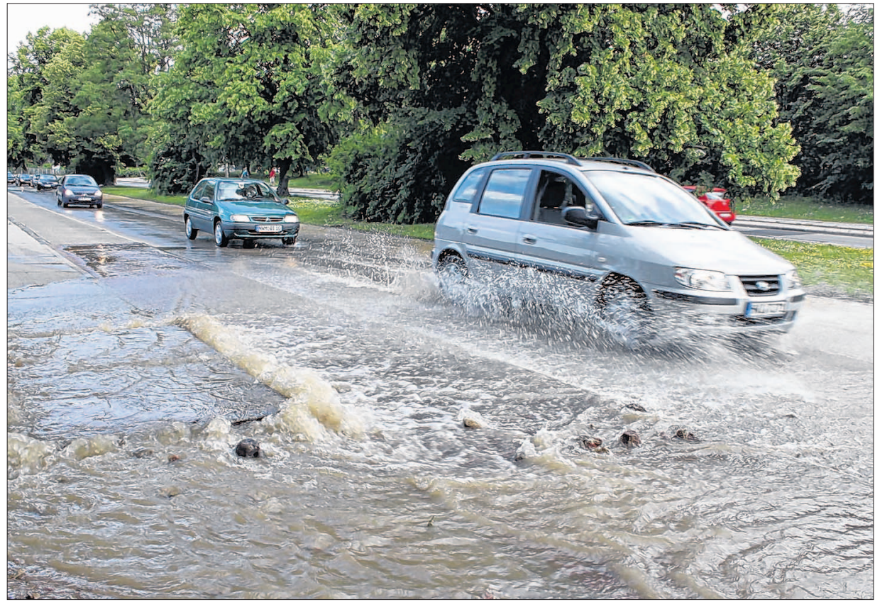
Das Wasser sprudelte nach einem Rohrbruch unter dem Bordstein vor dem Wonnemar in der Bürgermeister-Haupt-Straße hervor. Foto: U. Oehlers
